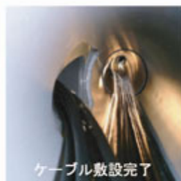
既設ケーブルの上を通過
